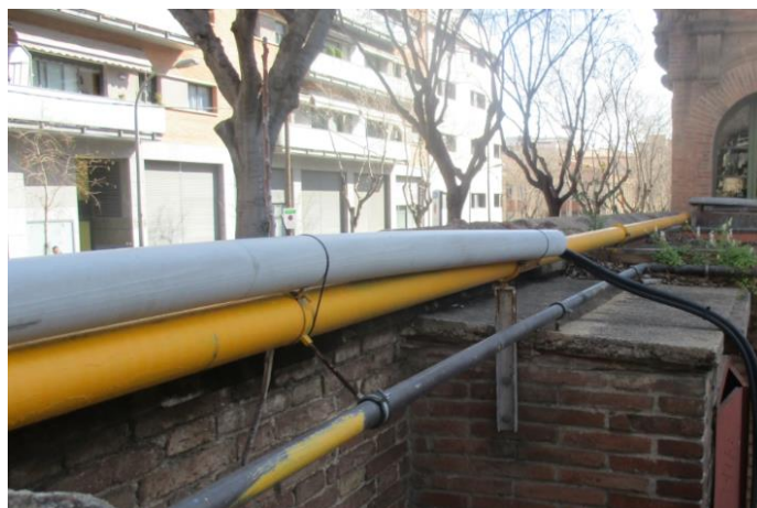
Canonada d'entrada de gas a la instal·lació.
