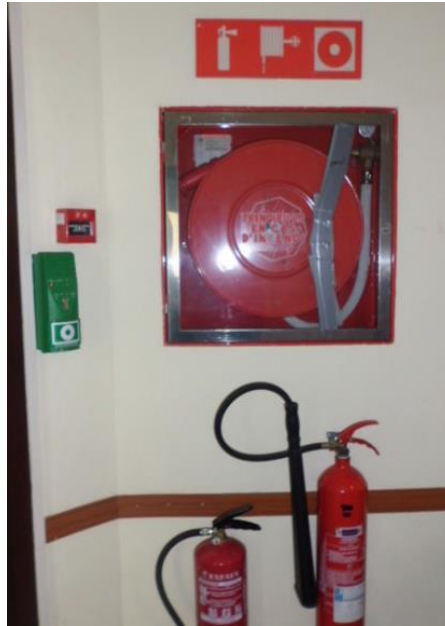
Equips de lluita contra incendi a l'edifici
